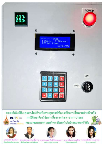
รูปที่ 13 ตู้ควบคุมระบบ
